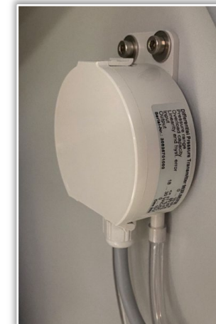
Überwachung Filterzustand über Filter-Differenzdruck
