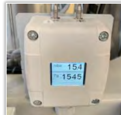
Überwachung Filterzustand (DDMU)
